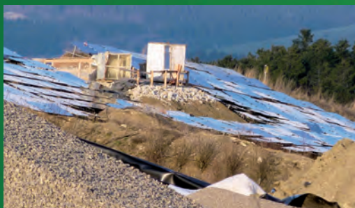
Ehemalige Kreismülldeponie Tuningen – so sieht es aus, wenn die Energiewende ins Rutschen kommt!
